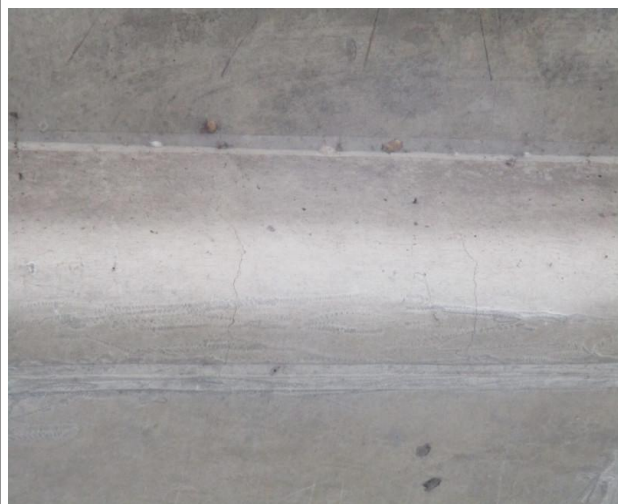
【바닥판 하면 균열/온도변화, 건조수축】
