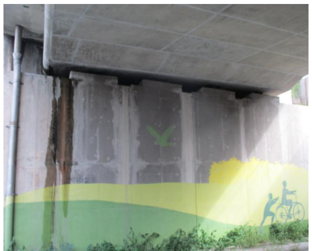
【교대 누수 및 누수흔적/우수유입】
