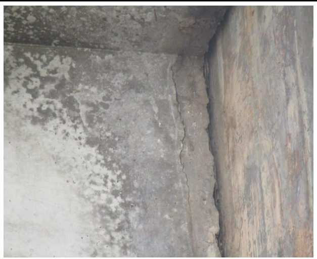
【바닥판 하면 균열/온도변화, 건조수축】
