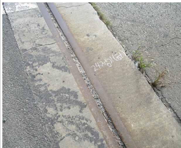
【신축이음장치 부식/공용기간 증가】
