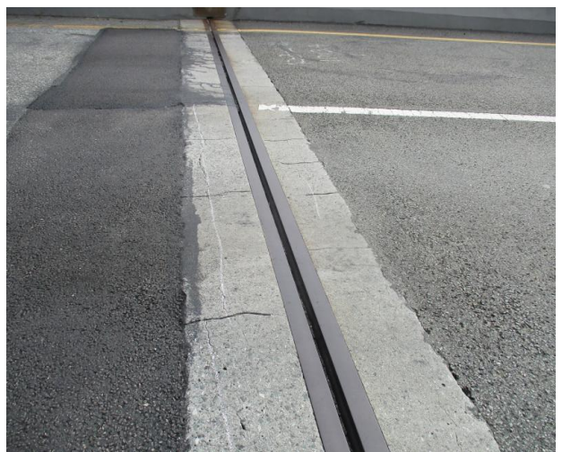
【후타재 균열/차륜하중 반복】
